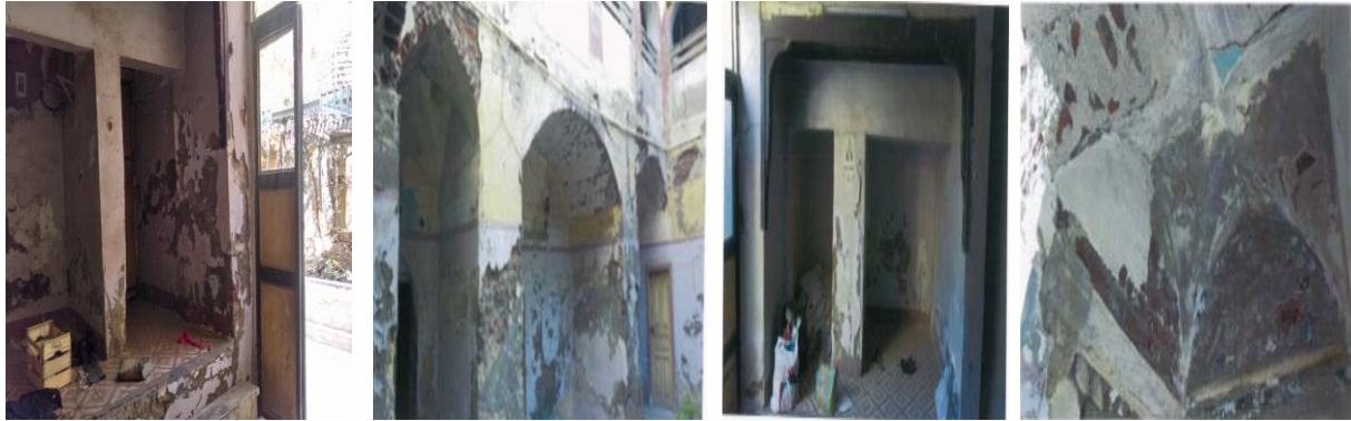
شكل (١٥) سقوط الدهانات الداخلية وتآكل الحوائط
