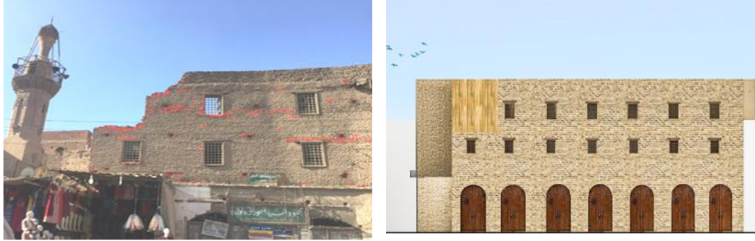
شكل (٢٢) استكمال الواجهة ومعالجة الشروخ الموجودة بها
