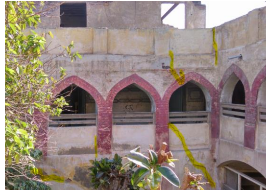
شكل (١٧) الشروخ والتصدعات في الواجهة
